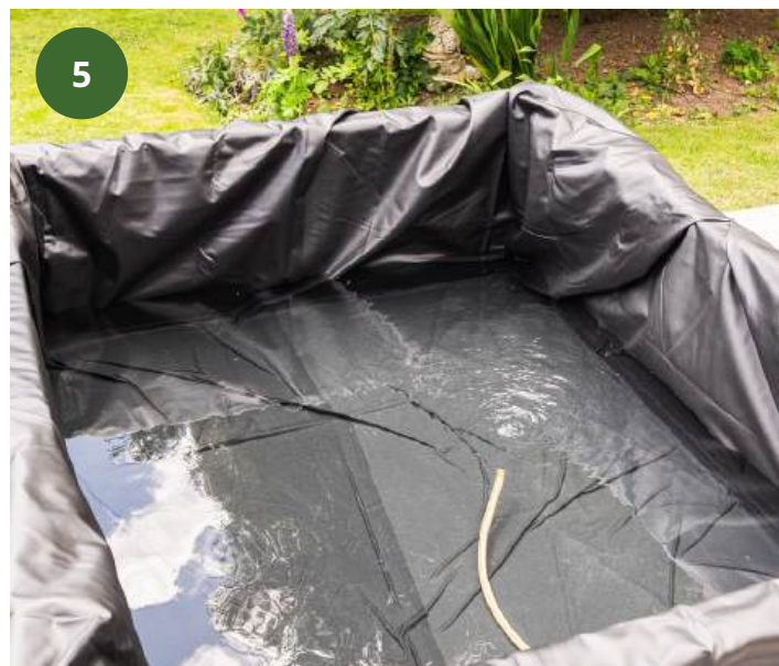
Remplissage – laissez la bâche trouver sa position naturelle au sein de la structure au fur et à mesure que celle-ci se remplit.
